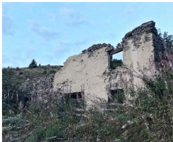
Façade effondrée partiellement Août 2017
